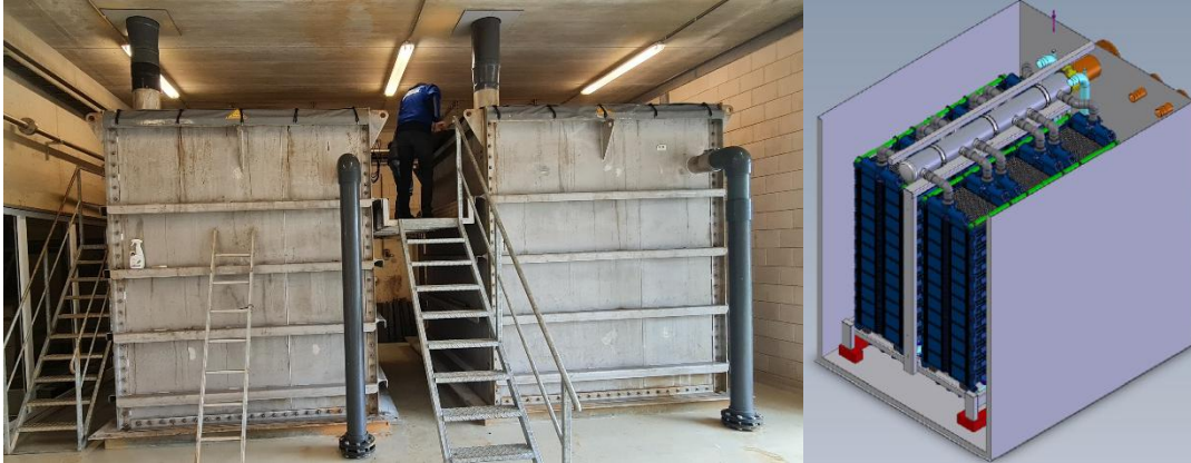
Abbildung 22: Spülwasseraufbereitungsanlage der Fa. Vitens mit keramischen Flachmembranen (Al 2 O 3 ) der Fa. CERAFILTEC in 2 Filtrationstanks mit 2 mal 66 Modulen, in Summe 792 m 2 Membranfläche.
