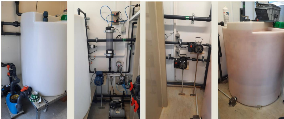
Abbildung 9: Innenleben des Pilot Containers: Permeattank mit Permeat Drainpumpe, Filtrationspumpe und gepulste Rückspülung, Schlammumpen, Schlamm Speicher (von links nach rechts)
