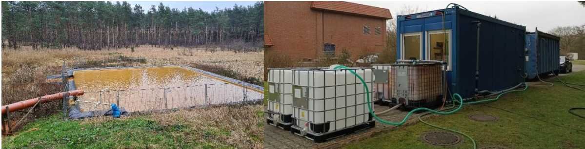
Abbildung 16: Sammelteich für Spülwasser OOWV (linkes Foto) und Aufstellung der Pilotanlage (rechtes Foto): von rechts nach links: Vorlagecontainer, Anlagecontainer und IBC für Schlammproben und Abwasser aus Membranreinigung
