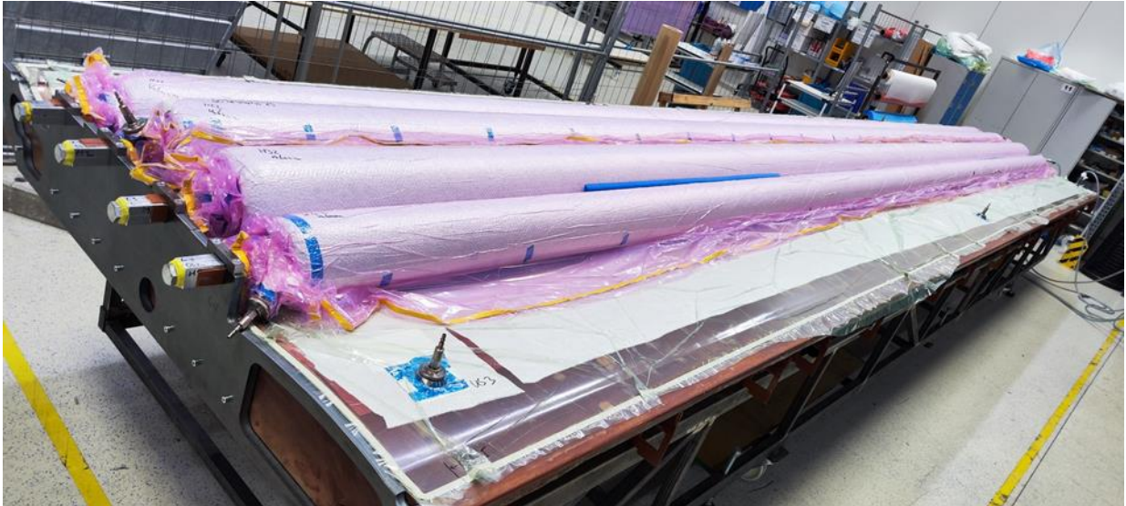
Abbildung 17: Vakuumaufbau des UFS mit Tankröhren
