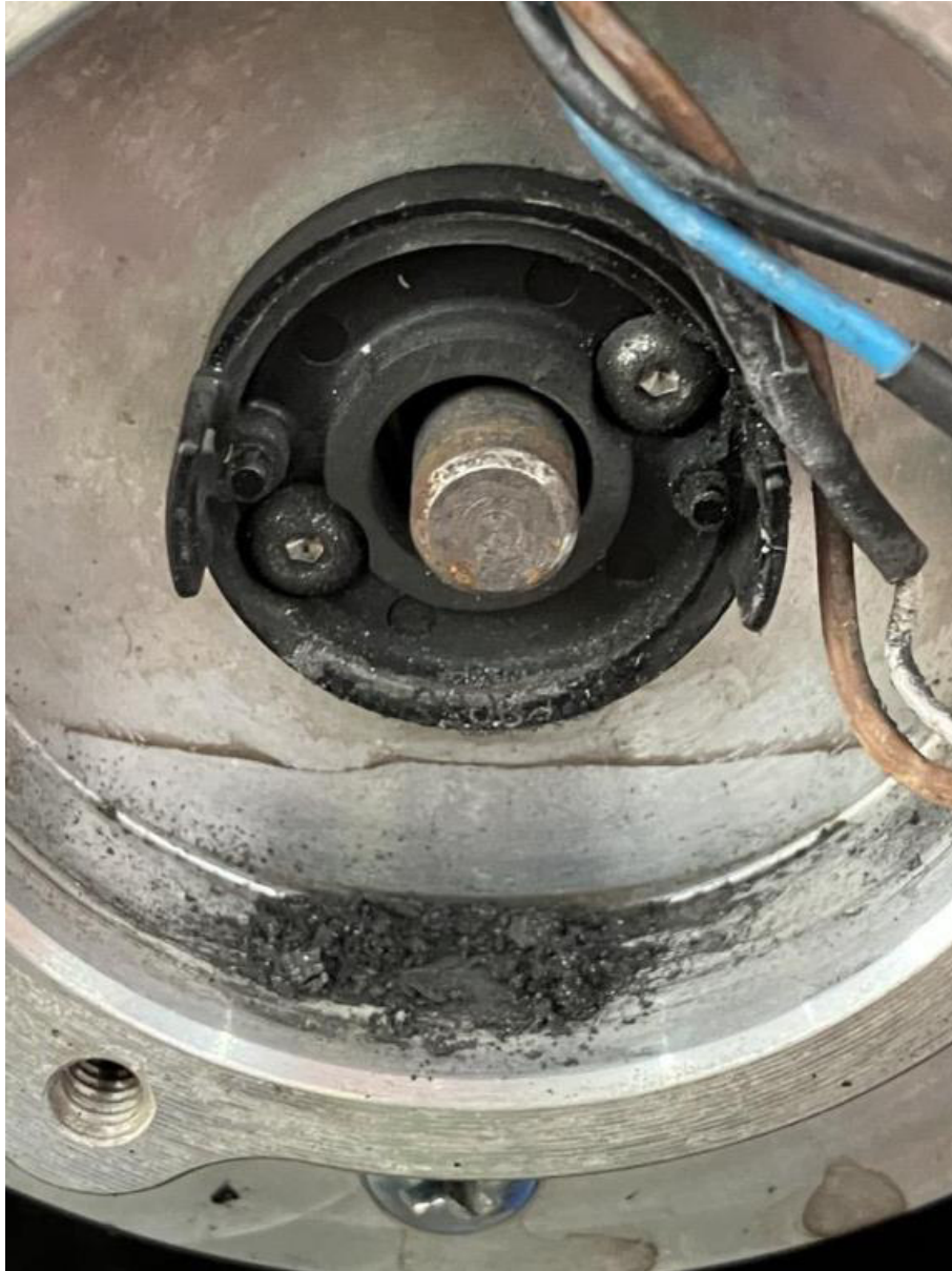
Abbildung 10: Abrieb nach Demontage eines defekten Drehzahlsensors
