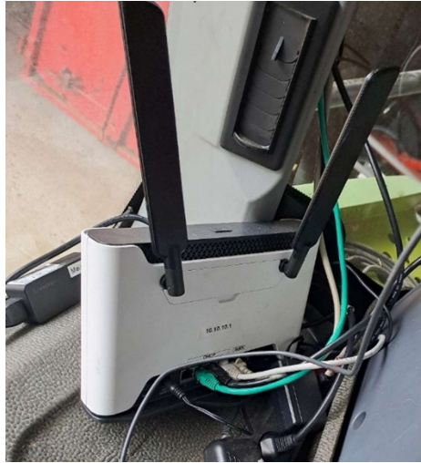
Bild 8: F4P0-Router in der Fahrerkabine
