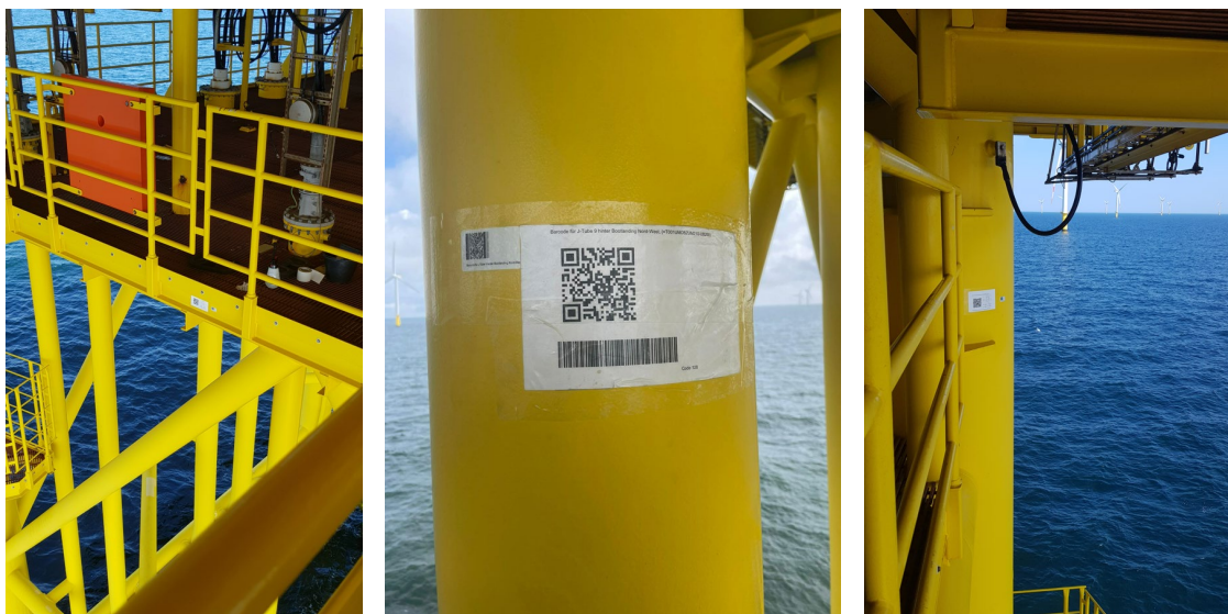
Abbildung 26: Etiketten mit Barcode-Labels an der Offshore-Umspannstation
