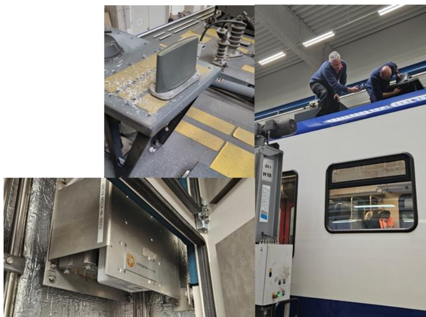
Abbildung 13: Einbau der Transpondereinheiten inkl. Antennen
