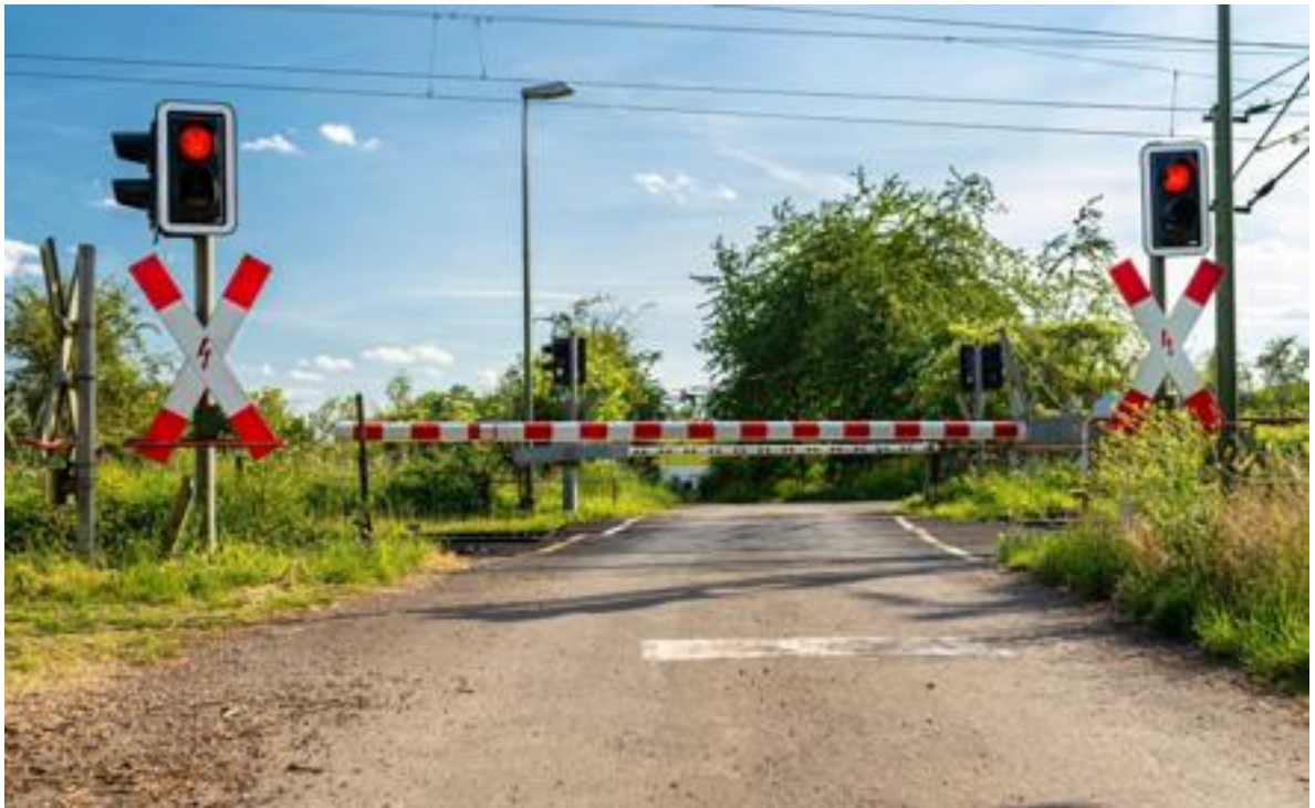
Abbildung 1: Technisch gesicherter Bahnübergang mit Vollschraken und Lichtsignalanlagen [10]
