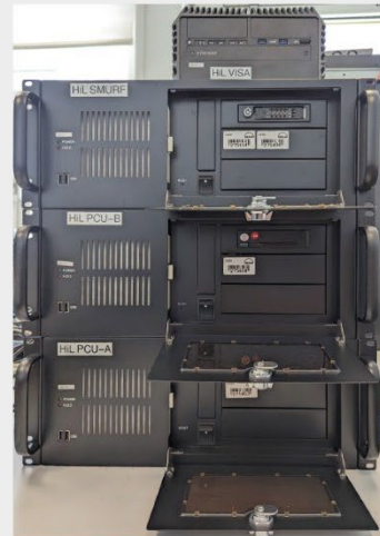
Rechnereinheit der neuen autonomen Plattform
