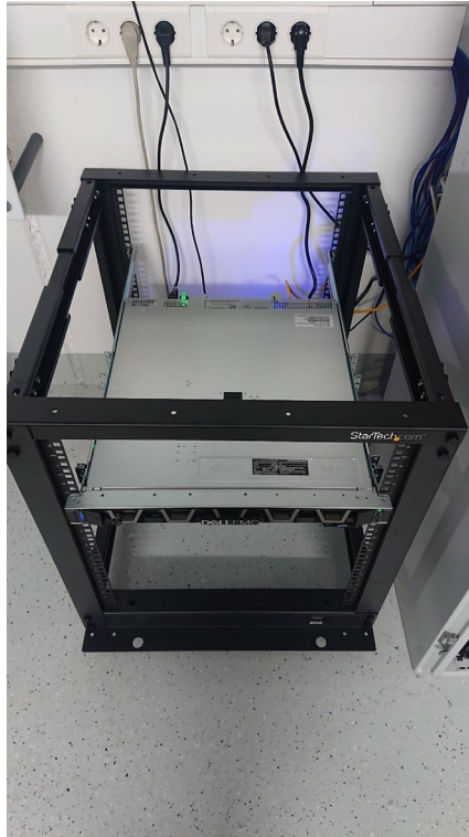
Abbildung 2: Aufgestellter Server im Rack in der Technikzentrale des Gebäudes
