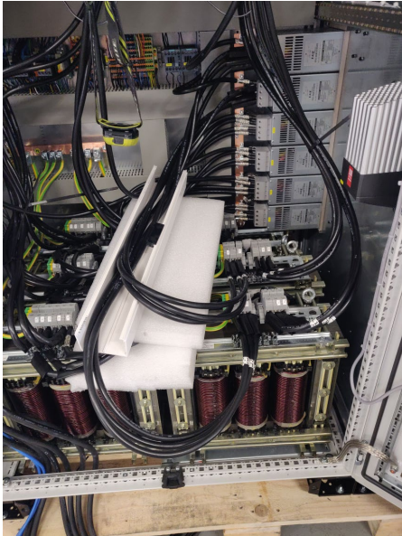
Abbildung 2: EMV optimierte Drosseln in 300 kW Stromrichter- Anlage
