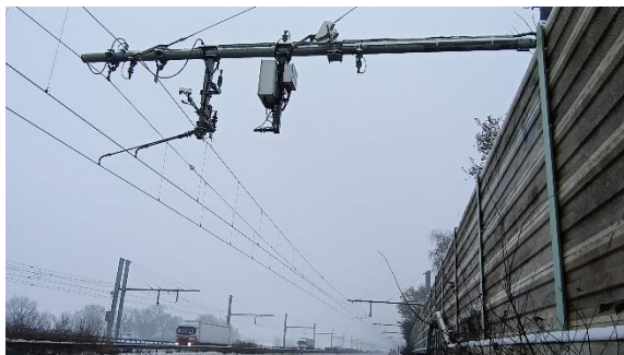
Abbildung 24 - Erweitertes Messsystems an Messstandort Mast 46-18
